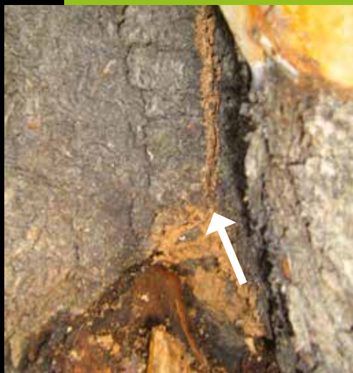
1 - Sillon provoqué par les cordonnets
